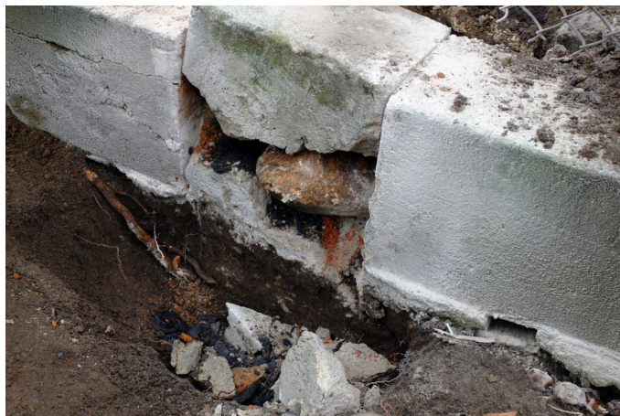
Rys. 6. Pobieranie próbek z podmurówki, widoczne fragmenty dużych kamieni w betonie zastosowanych jako wypełnienie.
